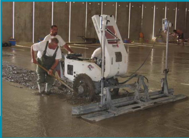
Бетонные работы на фирме «Ханкоок» от партнера ROMEX® - DELTA-E Kft. • Concreting at Hankook by ROMEX® partner DELTA-E Kft.
